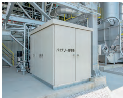
焼却炉の自家発電装置
